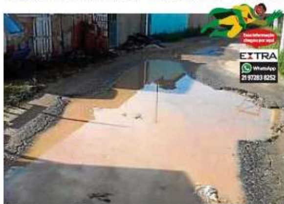
A lama toma conta da pista da Avenida do Canal, em Caxias
