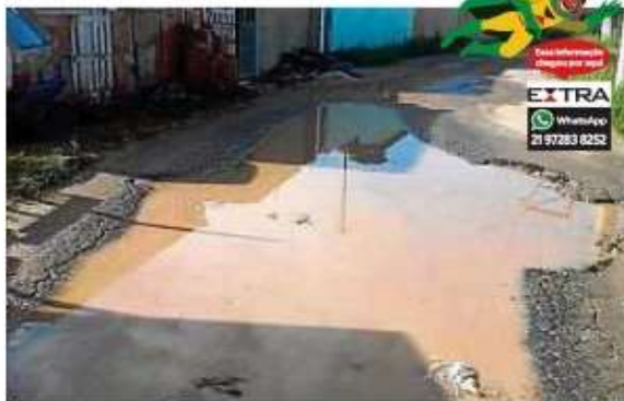
A lama toma conta da pista da Avenida do Canal, em Caxias
