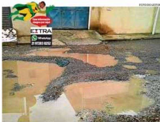
A água fica acumulada em buracos na Rua Santa Helena
